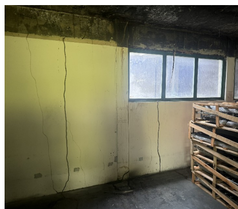
Figura 09 – Cupim no teto e parede
